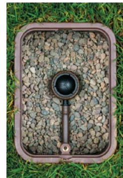
Válvula de descarga automática instalada
