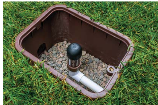
Válvula de ventosa de aire/vacío instalada
